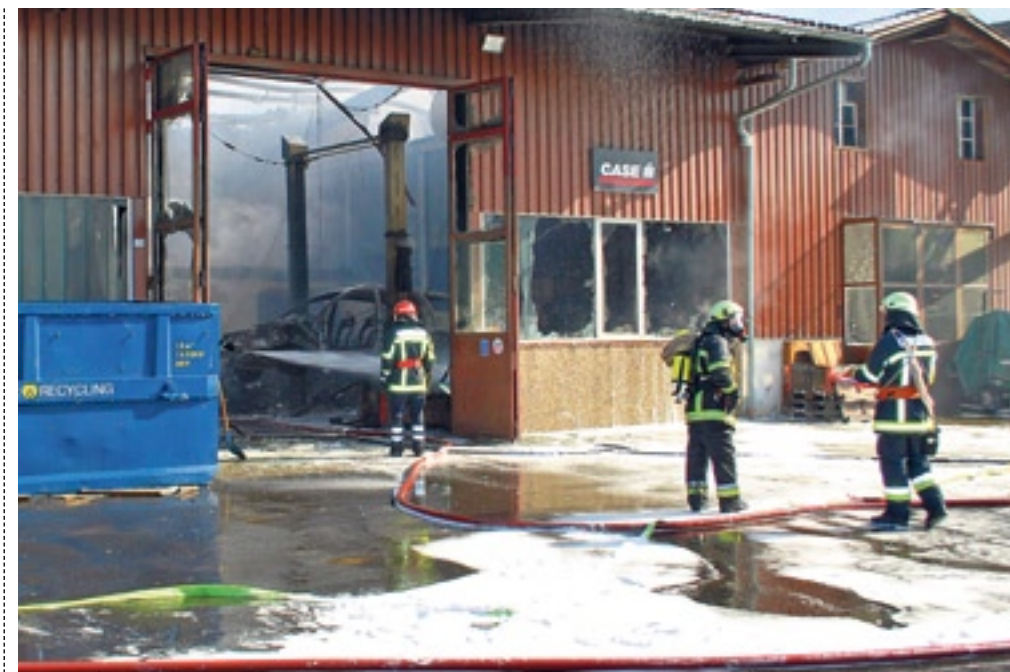
Die Werkstatt in Grosswangen ist durch das Feuer stark beschädigt worden. LUZERNER POLIZEI
